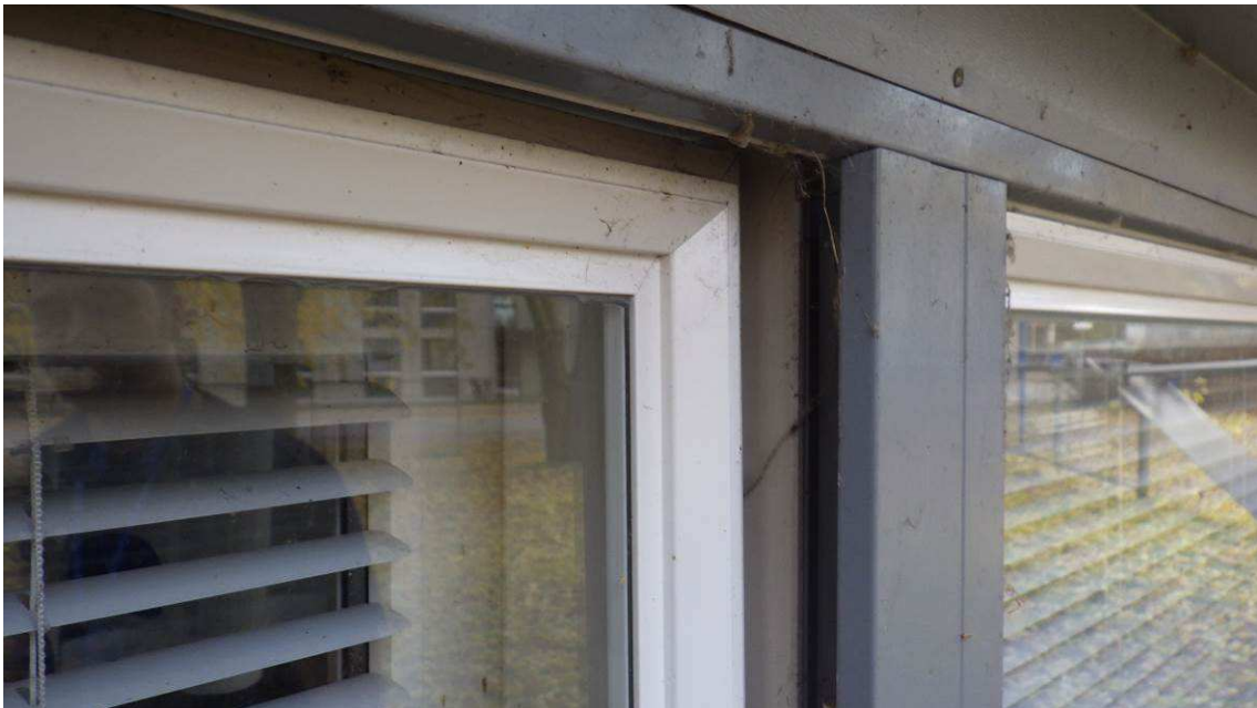
Kuva 12. Ikkunat liikkuvat vähäisestäkin voimasta.
