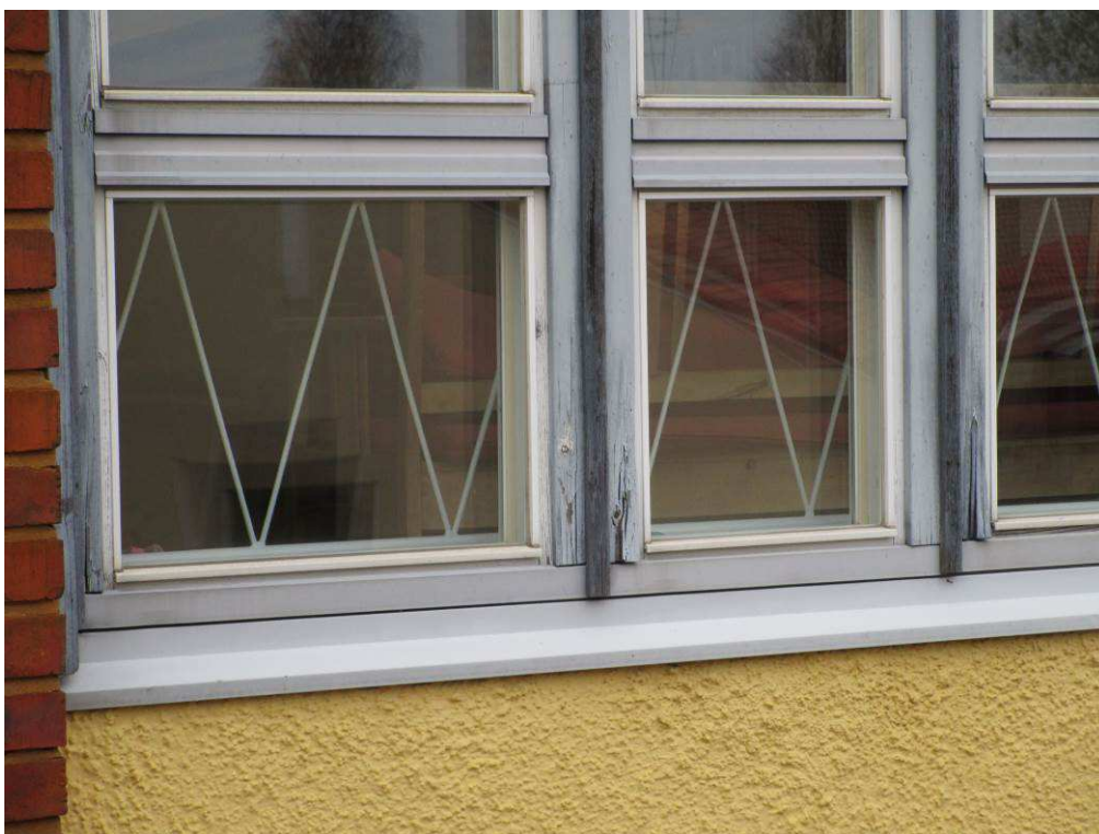
Kuva 16. Ikkunoiden puuosissa on yksittäisissä kohdissa jo lahovauriota
