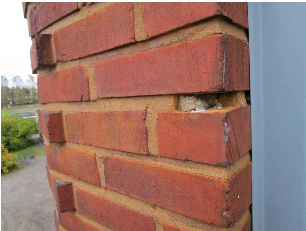
Kuva 5. Puhtaaksimuurattujen osien vaaleat jälkisaumaukset (arviolta huomattavan kalkkirikkaat) ovat erittäin pehmeitä ja saumauksissa on runsasta halkeilua/rapautumaa
