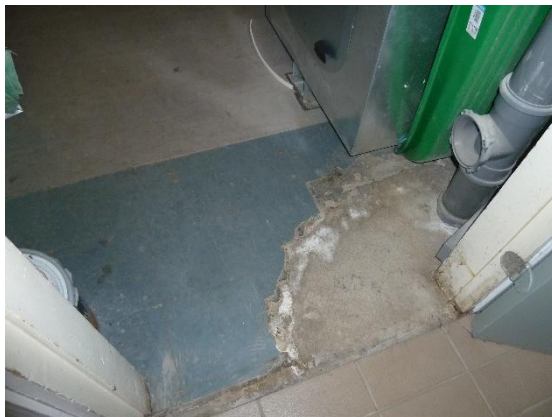
Kuva 8. IV-konehuoneen lattian sinisestä vinyylilaatoituksesta otettu näyte 9 sisälsi asbestia.
