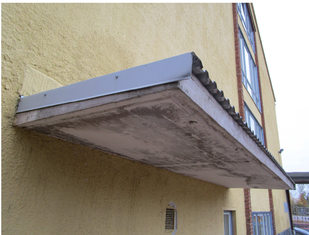
Kuva 8. Lounaisnurkan kattolipan alapinnan pinnoitteet irtoilevat laajasti ja alapinnassa on yksittäisiä näkyviä betoniteräskorroosiovauriota
