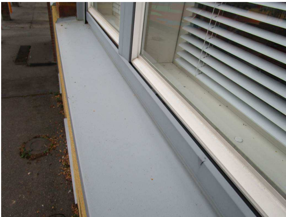
Kuva 15. MSE-AL ikkunoiden alakarmien ulkopintojen alumiinilistojen kiinnityksiä on osin irronnut
