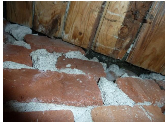
Kuva 11. Kattolaudoituksen takana oleva bitumi-huopa-aluskate sisältää asbestia.
