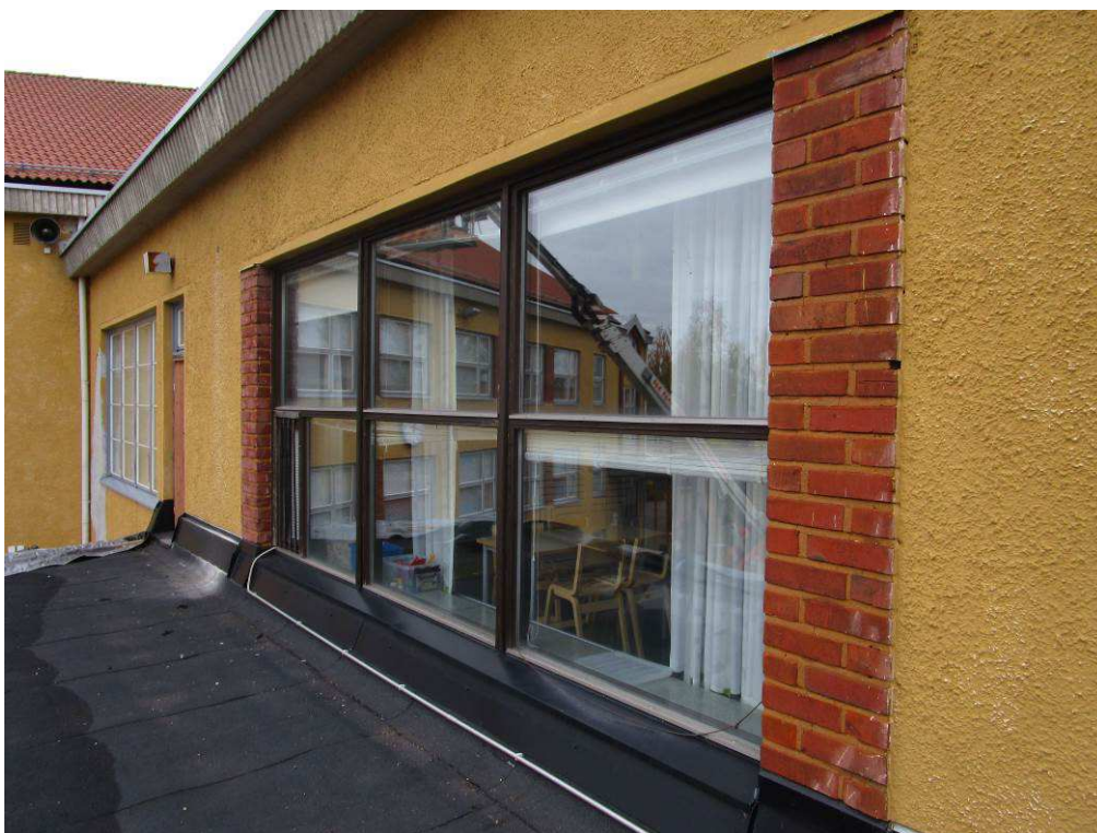
Kuva 17. Ikkunoiden puuosissa on runsastakin haristumista, pääkatoksen yläpuoliset
