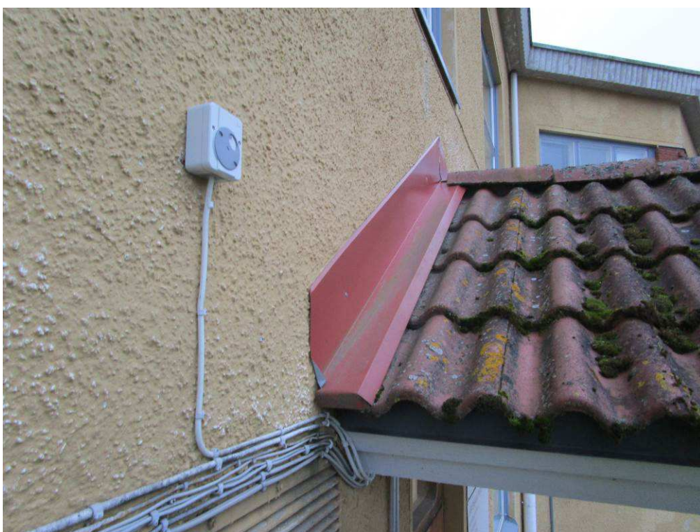
Kuva 12. Julkisivun pinnassa on runsaasti pintakaapelointeja pohjoissivulla
