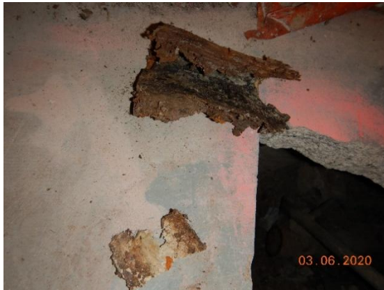
Kuva 4. Kanaalien pohjalla on irtonaista asbestipitoista eristemassaa (näyte 6).
