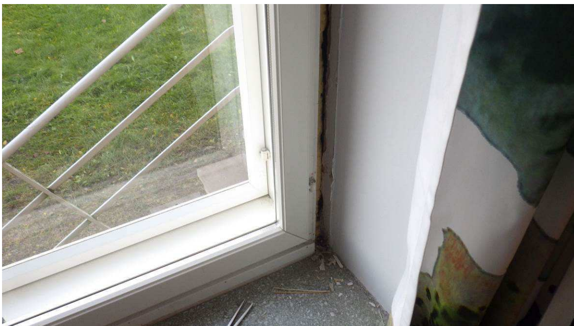
Kuva 10. Ikkunanpielten uretaanitäytöt olivat useissa paikoissa epätiivitä paljastaen vanhat täyttömateriaalit.
