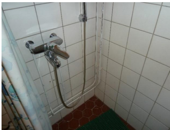
Kuva 6. Tilan 077 seinälaatan kiinnityslaasti sisältää asbestia.
