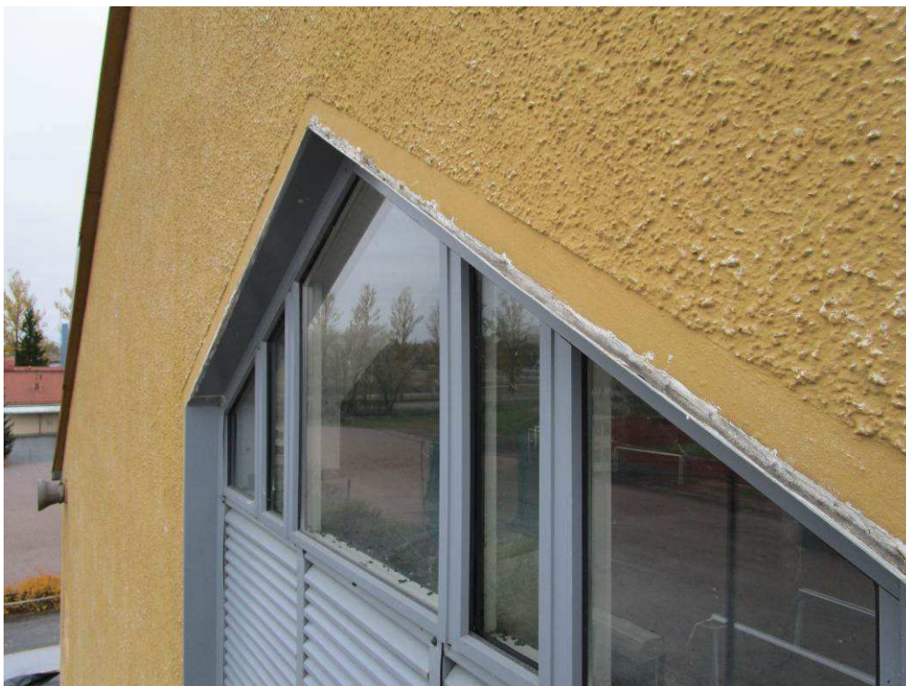
Kuva 13. Pellityksien toteutuksissa on puutteita, yläsmyygipelti ohjaa vesiä sisäänpäin, kittaus epätiivis
