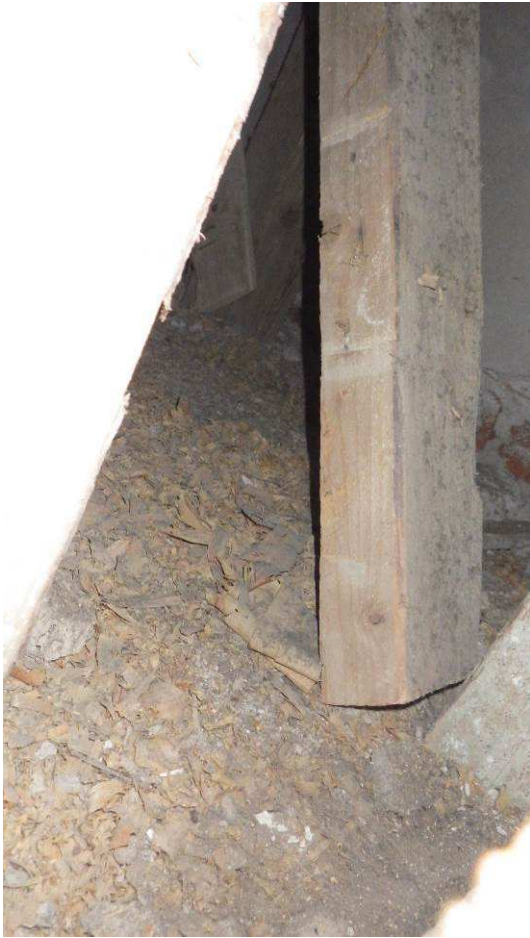
Kuva 6. D-sisäänkäynnin vieristen portaiden alapuolella havaittiin melko runsaasti rakennusjätettä, joka aiheuttaa hajuhaittaa viereiseen toimistotilaan
