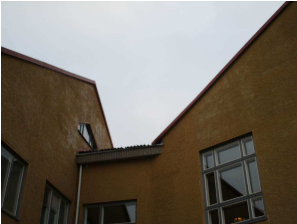
Kuva 2. Säärasitetuimmilla osin julkisivun maalipinnoite irtoilee/on peseytynyttä
