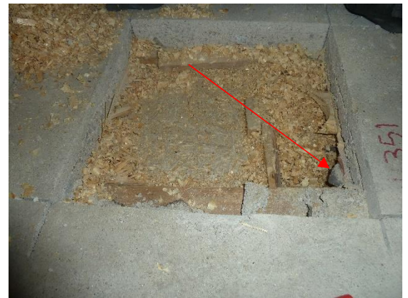
Kuva 13. Yläpohjarakenteessa on musta tervapaperi (näyte 25) pintalaatan ja alla olevan sementtipuukuitulevyn välissä. Tervapaperi sisältää erittäin runsaasti PAH-yhdisteitä!
