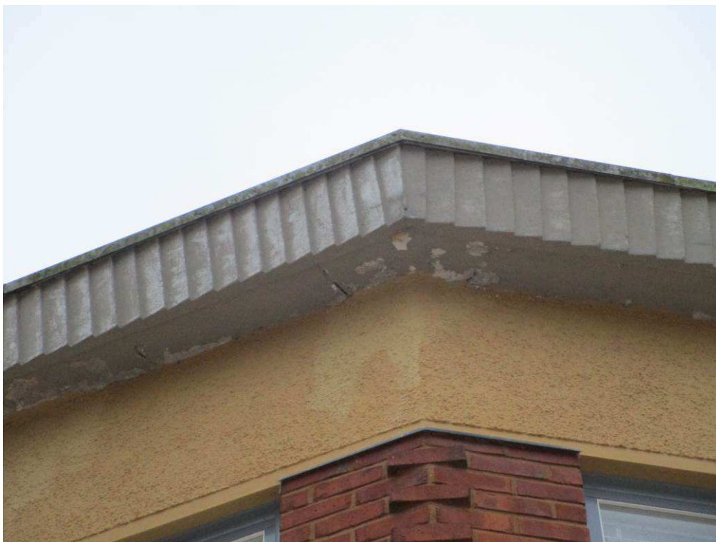
Kuva 7. Maalatuissa betoniräystäissä on kohtuullisen runsaasti vuotojälkiä ja näkyviä betoniteräskorroosiovauriota
