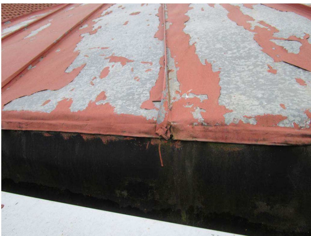
Kuva 10. Peltikattoisen osan vesikaton maalipinnoite irtoilee laajasti, vedenpoisto tapahtuu betoniräystään sisässä olevien "ikikourujen" kautta
