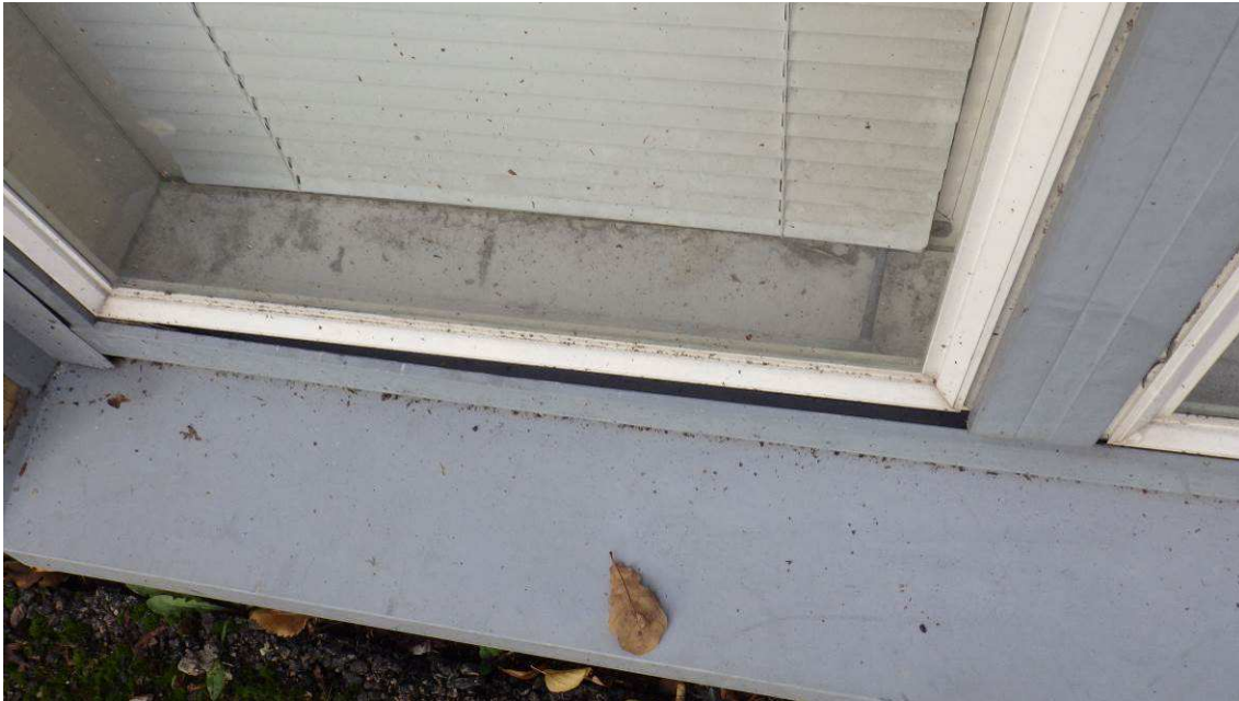
Kuva 13. Ikkunan väliin on päätynyt kosteutta ja likaa.
