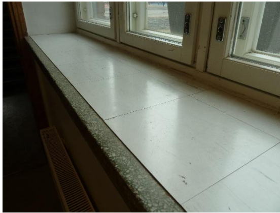
Kuva 10. Ikkunalaudan vinyylilaatoituksesta otettu näyte 11 sisälsi asbestia.
