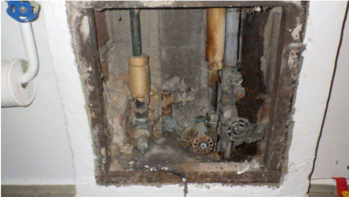
Kuva 4. Vuotovaurio kellarissa putkikanaalissa. Kaikki ympäröivät rakenteet ovat kastuneet.
