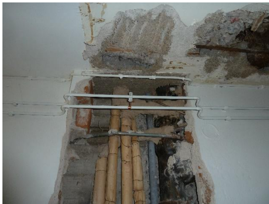
Kuva 2. Käytävällä 042 seinää on purettu ja seinän sisällä olevat asbestipitoiset putkiseristeet ovat näkyvillä. Putkissa on pinnoittamaton asbestipitoista massaa, mikä aiheuttaa riskin asbestikuitujen kulkeutumisesta sisäilmaan.
