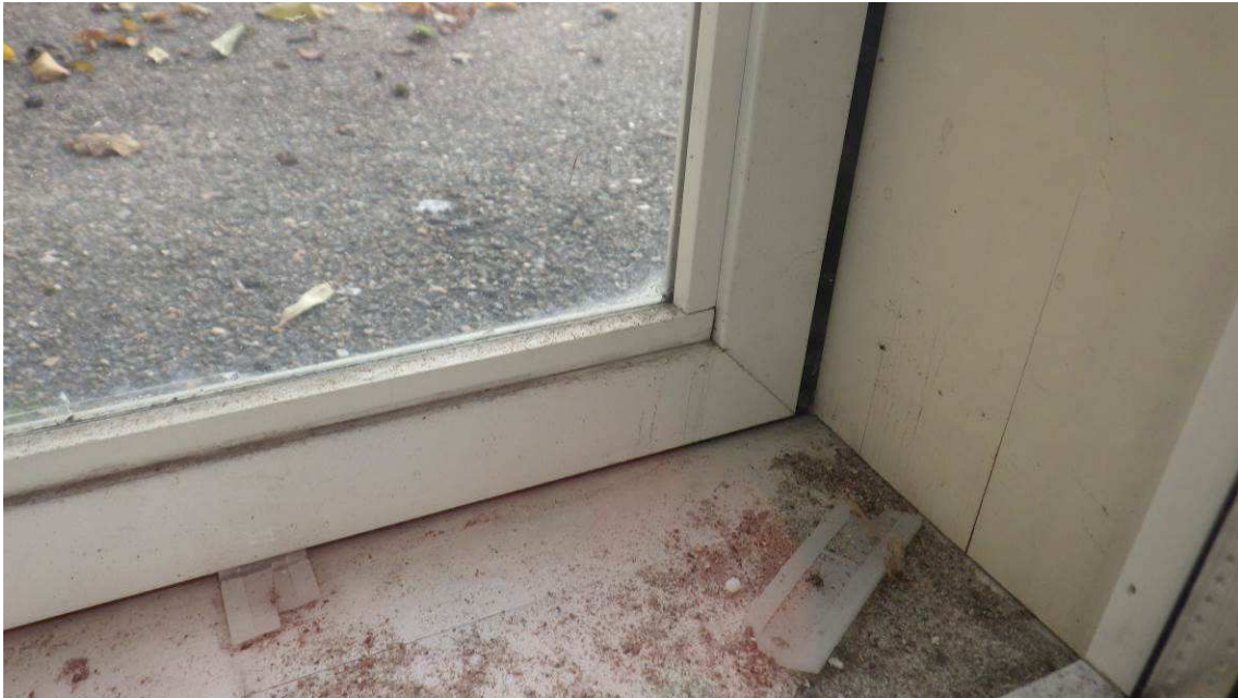
Kuva 11. Ikkunoiden väleihin kertyy hiekkaa ja likaa.
