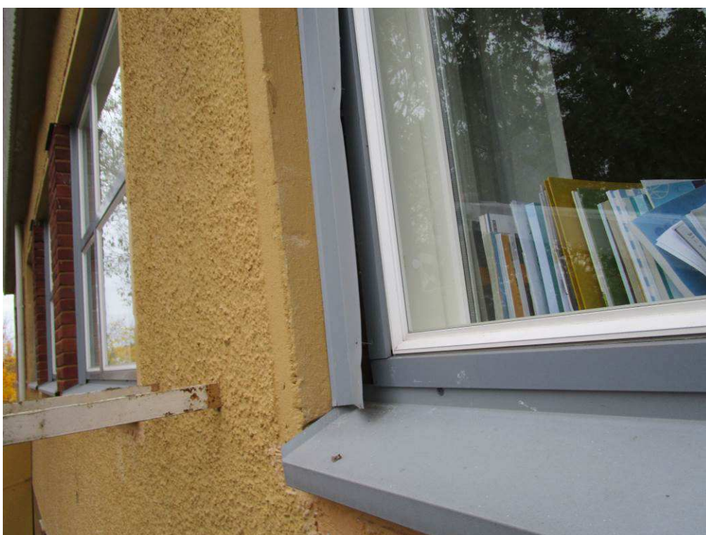
Kuva 14. Pellityksien toteutuksissa on puutteita, smyygipelti irronnut
