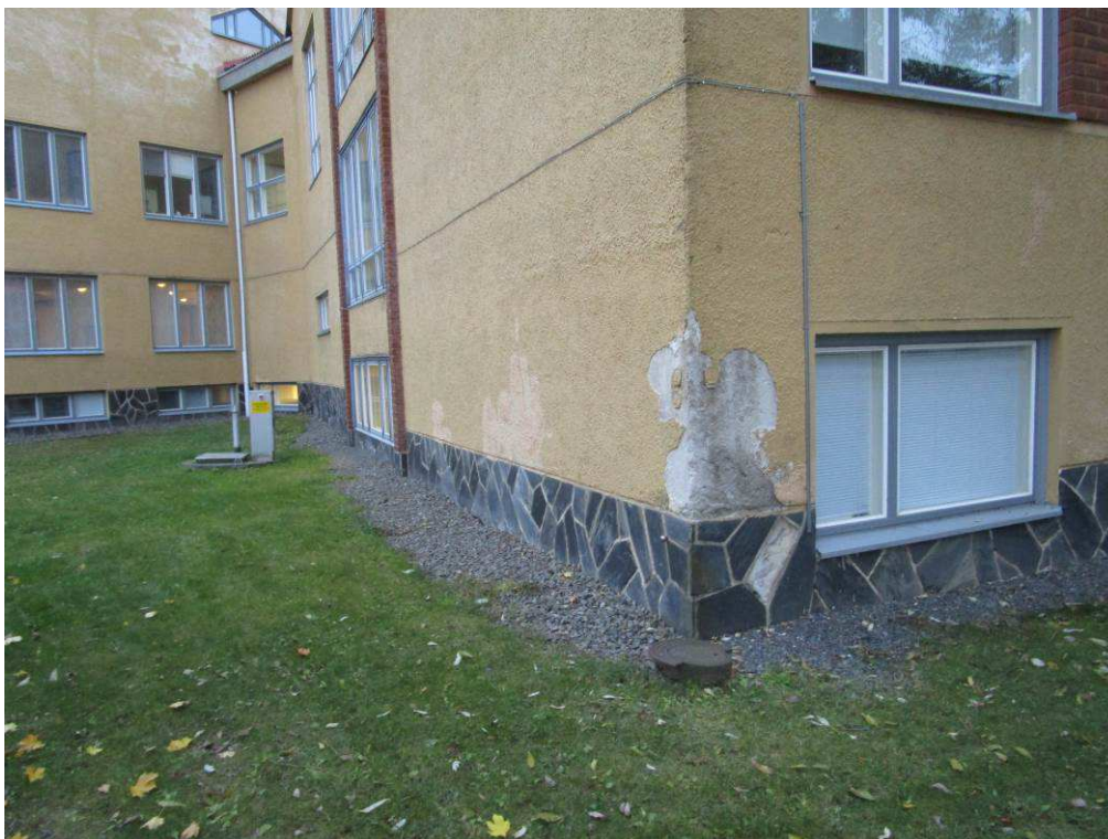
Kuva 3. Seinien alaosissa on osin oletettavasti mekaanisista iskuista aiheutuneita vaurioita, yksittäisiä liuskekiviä on irronnut kokonaan
